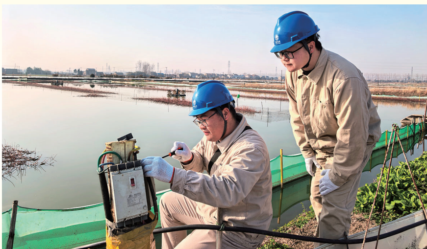
16日,市供电公司临泽供电所员工前往临泽镇周巷村大闸蟹育苗基地,检查池塘里的电力增氧泵及断路器,保障塘口在寒流低气压天气情况下安全用电。图为检查现场。
