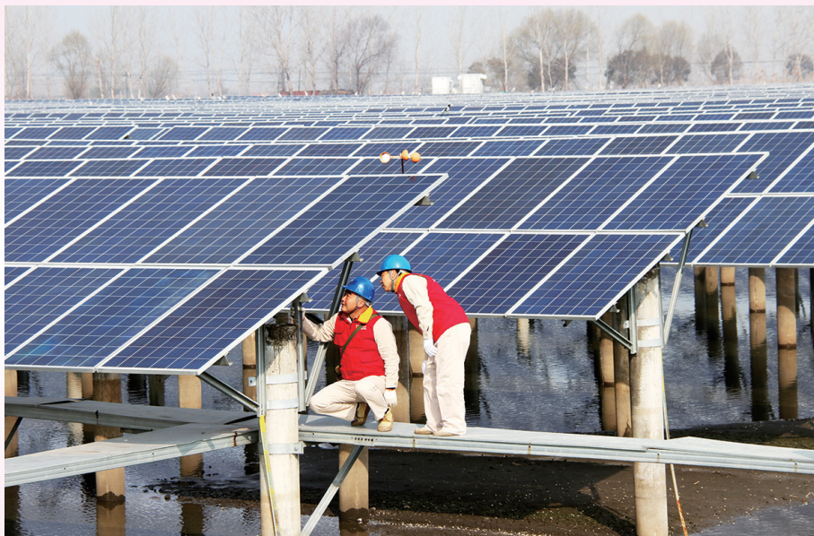
日前,市供电公司组织党员服务队队员前往甘垛镇官林村北侧的500亩荡区光伏发电站,义务检查和维修太阳能板等设备,确保发电站可靠发电。图为检查现场。 林华鹏 陈建文 正摄影报道
