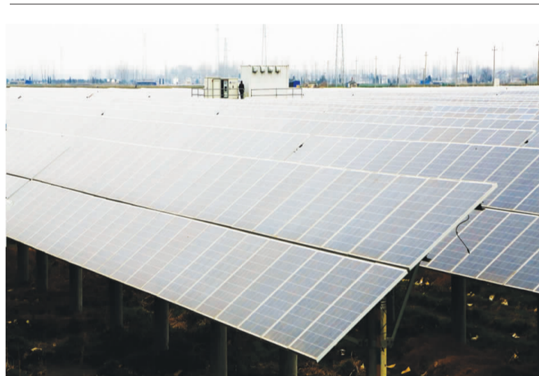
去年初,总投资20亿元的振兴新能源光伏发电项目落户临泽镇陈甸村,占地面积5500亩,一期工程120MW电站已建成并网发电,日均发电量可达50万KWh,全年可实现销售约1.3亿元。目前,该项目二期工程建设正在有序进行中。
