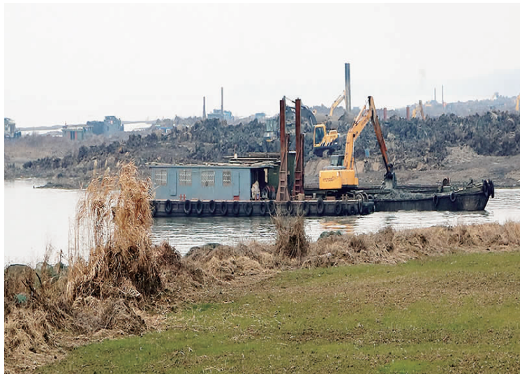
新民滩切滩工程目前进展顺利。该工程弃土840多万方,市政府将运河二桥高邮湖西北侧低洼地作为弃土堆放区,可增地1080亩。预计整个工程于今年上半年完工并投入使用。图为施工人员正在湖区施工的场景。 王林山 摄
