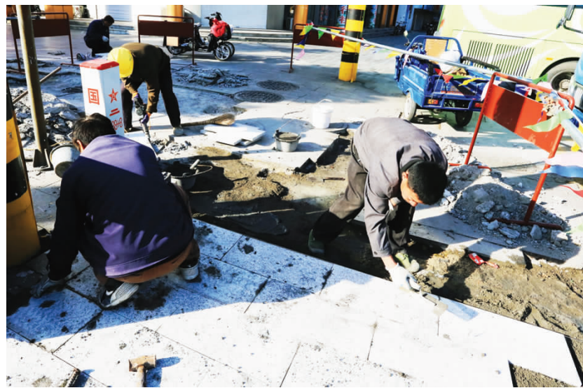
近年来,我市大力实施城建重点工程的同时,注重已建基础设施的维护完善,全面提升城市形象。图为市城建投资公司近期正组织施工人员对文游路、海潮路、烟雨路等道路破损处进行维修保养。
