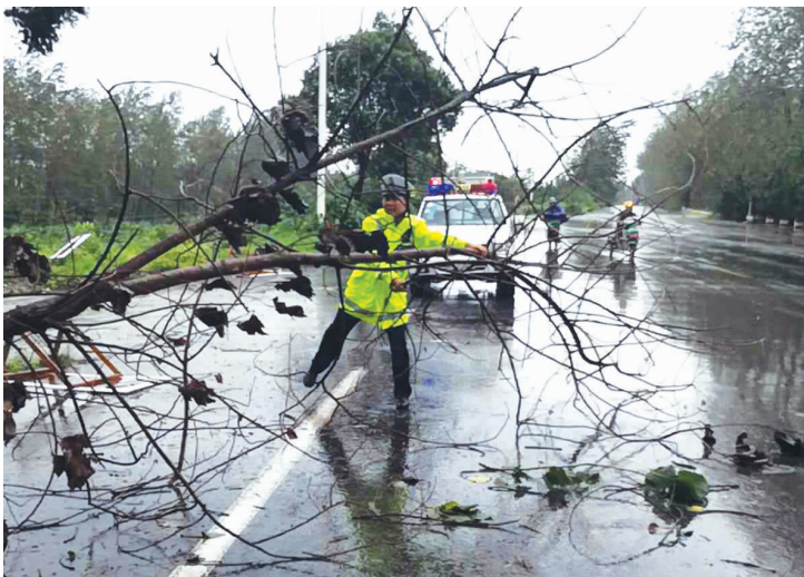
受台风“温比亚”的影响，8月17日至19日，我市出现暴风雨天气，辖区境内多条县乡道路上的树木被刮断，横倒路中间。为确保道路交通安全，交警等部门组织人员对辖区道路进行全面巡逻，期间，发现老淮江线、屏淮路等路段约20棵大树被连根刮倒后，及时进行清理，保障了道路畅通。图为清理现场。 周明宝 张林 匡杰 摄影报道
