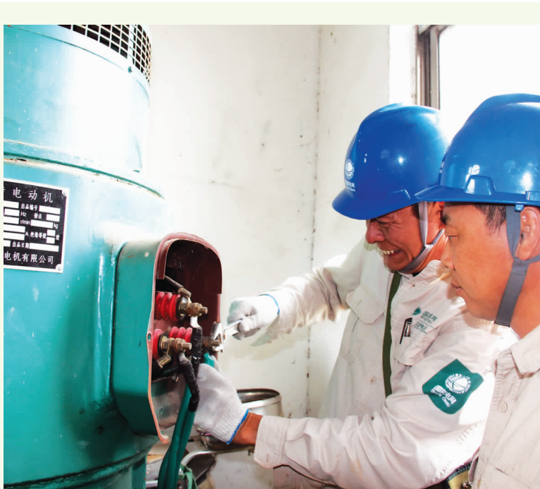
为确保汛期供电设施正常运转,连日来,市供电公司组织城乡 13 个供电所的职工,对全市 600 多座排涝站泵房的用电设施进行全面检查与维护。图为甘垛供电所职工正在该镇新庄村排涝站维护电气设备。 林华鹏 管玮玮 摄影报道
