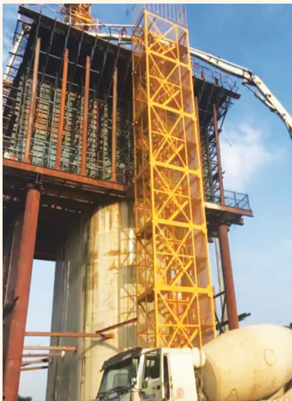
9 月 9 日,经过铁路工程施工人员 20 多个小时的连续奋战,连镇铁路 5 标段跨京沪高速高邮匝道连接桥墩成功浇筑。该工程跨度大,中心梁高 8.6 米,宽 12.2 米。
