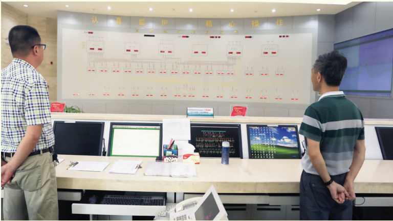
受持续高温影响,空调负荷加大,水产养殖用电量比重持续增加,我市电网调试负荷连续5次刷新记录。市供电公司针对高温天气还将持续的现状,加强负荷预测和电力平衡分析,全力以赴保障我市电网的安全稳定运行。 图为供电总调度室密切关注电网运行。 王林山 / 摄
