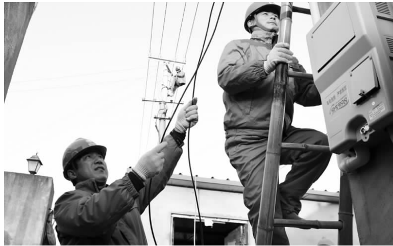
日前，我市最低气温已降至零下3℃。为保障居民在寒潮之际用电负荷增大情况下的可靠供电，市供电公司积极组织人员对一些用电负荷较大的配电台区的低压接户线进行整改。图为2日，临泽供电所员工正在临泽镇西河村1号配电台区配合外协单位整改接户线。 林华鹏 吴继明 摄影报道
