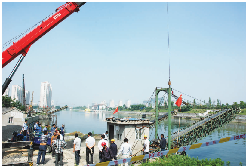
近日,市交通局港口、航道等单位会同市人民法院对北澄子河航道城区段沿线6户业主的砂石输笼进行强制拆除,及时消除航道安全隐患,营造良好的通航环境。 图为强制拆除输笼现场。 志强 建荣 王道 摄影报道
