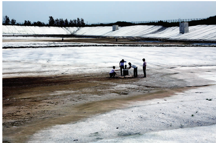
龙虬镇朱家生活垃圾填埋场新增扩容120亩工程已进入扫尾阶段，近期将投入使用。投入使用后，该填埋场日处理垃圾能力将达到300吨，将大大提升全市城乡生活垃圾无害化处理水平。图为专业人员正在验收新建的垃圾填埋场。林山/摄
