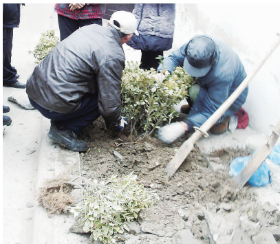
市北海新村37幢居民潘某擅自铲除院墙外公共花园,并拟破墙开门。日前,市容管理执法大队、城管治安大队和市园林处等部门联合现场执法,砸开已浇筑好的地坪恢复花园,并对当事人进行相关法律法规教育。 谢芳 姚静文/摄
